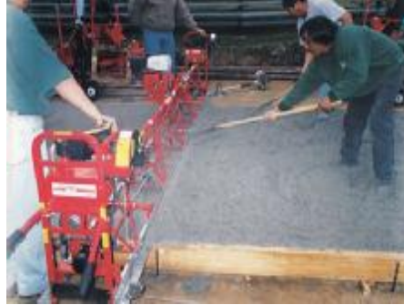
Figura 7.1-1 Empleo de jaladores para la colocación del concreto frente a la regla
