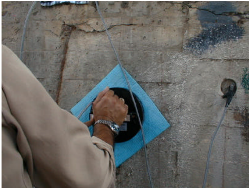
Figura 1.1 – Fotografía de una zapata de un puente en el estado de Tamaulipas en donde se observaron grietas producto de la corrosión del acero de refuerzo. La fotografía también muestra el sensor utilizado para determinar la velocidad de corrosión de una de las varillas afectadas por corrosión.
