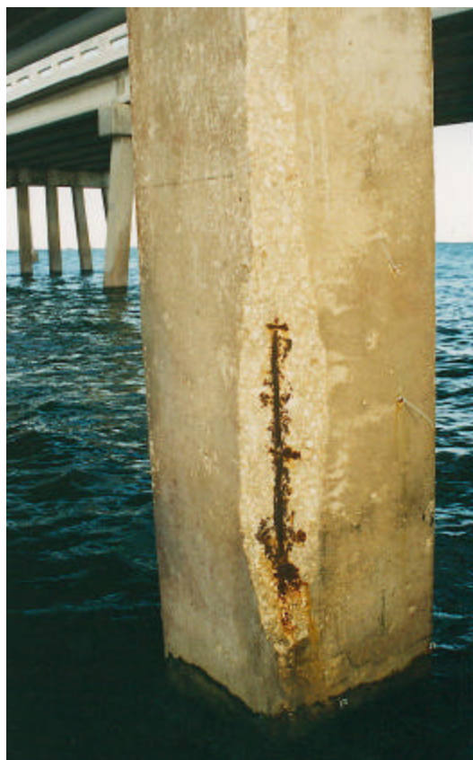
Figura 5.1 - Fotografía de la subestructura de un puente expuesto a un ambiente marino que se encuentra en su etapa de vida remanente.
