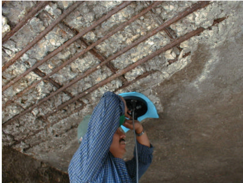
Figura 1.2 – Estado que presenta un puente en el estado de Michoacán en donde se aprecia el daño tan avanzado de la losa producto de la corrosión de la varilla de refuerzo.
